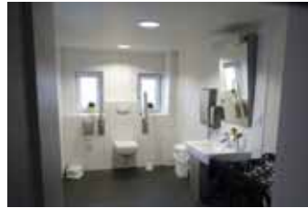
Neben dem barrierefreien Eingang wurde im Forsthaus auch ein rollstuhlgerechtes WC eingebaut.
