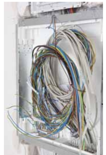
Noch haben die Elektrofirmen in den Claudius-Höfen einiges zu tun. Wenn alles abgenommen und in Ordnung ist, wird Haustechniker Matthias Trust dafür sorgen, dass das auch so bleibt.
